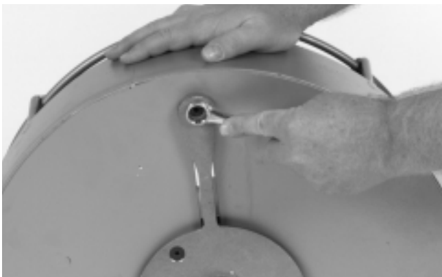
Figura 12 – Extracción del perno de enclavamiento de la "colita de cerdo"
